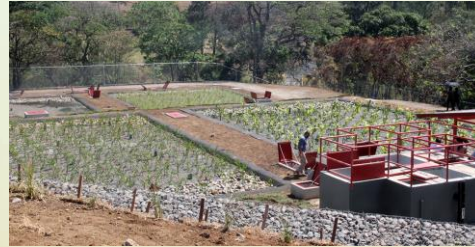
Sistema de Tratamiento Aguas Residuales Medicina Veterinaria
